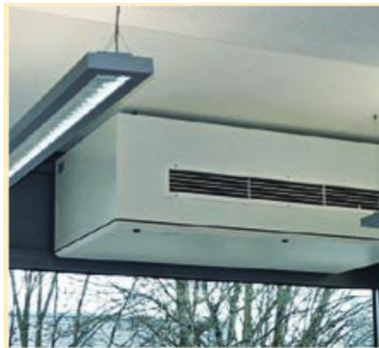
Figura 15 – Unità di ventilazione decentralizzata adottata nella scuola di Lindau
