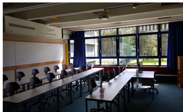
Macchina di ventilazione decentralizzata
